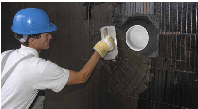
UFR in Mauerwerk
