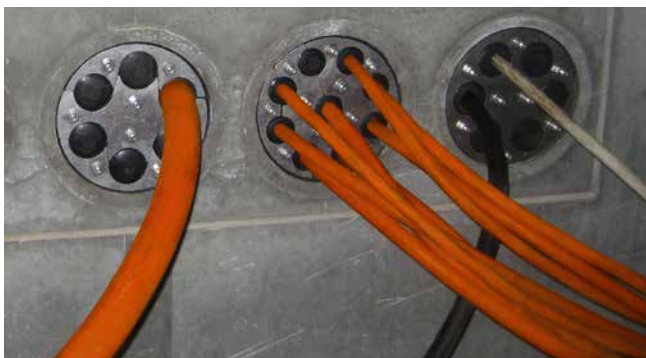
HRD150 SG eingebaut in Faserzementfutterrohre
